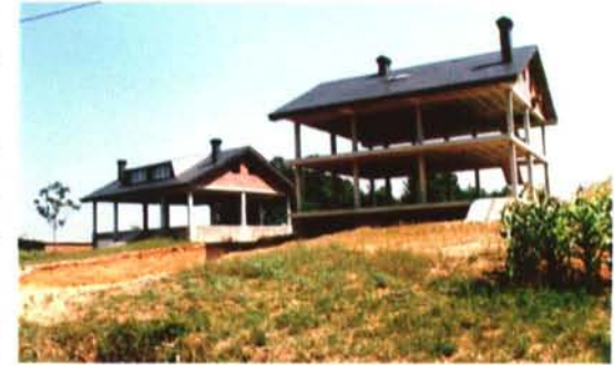
Estructuras de casas con procesos constructivos detidos. Margaride, Silleda.
