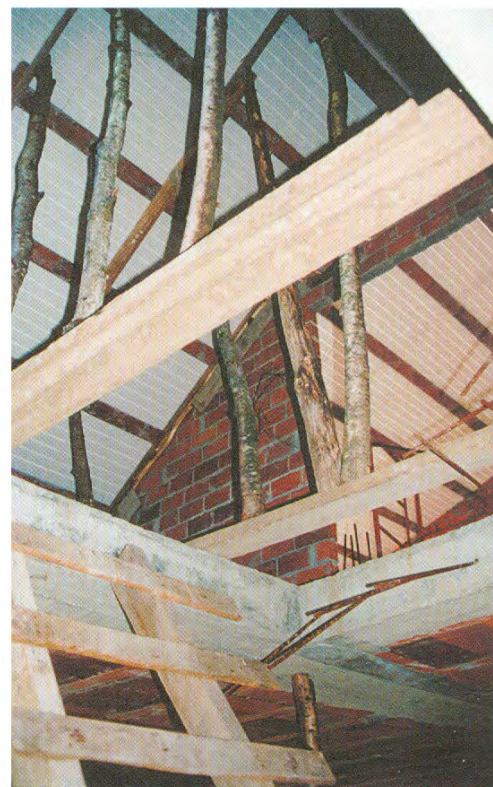
A utilización de bovedillas de poliestireno extrusionado –xeralizada na década dos 90– mellorará as condicións térmicas do baixocuberta tornándoo habitábel.
